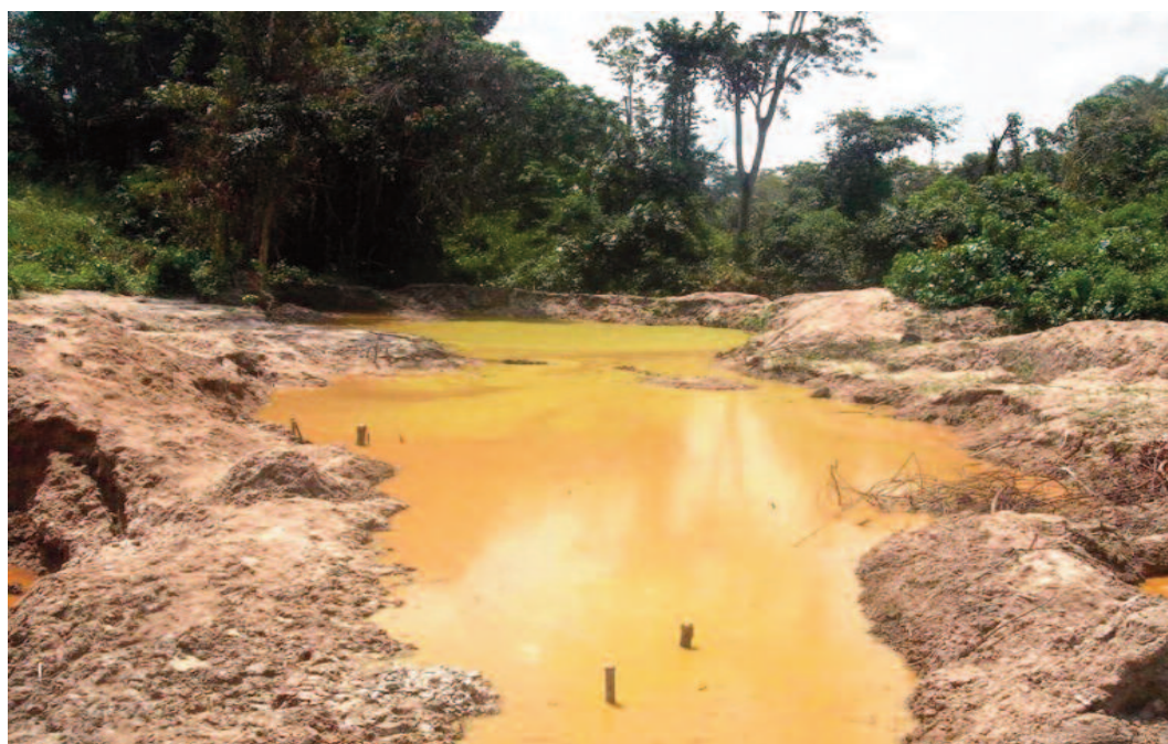
Photo 2 : chantier Loma : eau stagnante et trous non rebouchés
